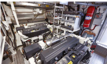
Im begehbaren Motorraum ist alles für Reparatur und Wartung gut zugänglich
